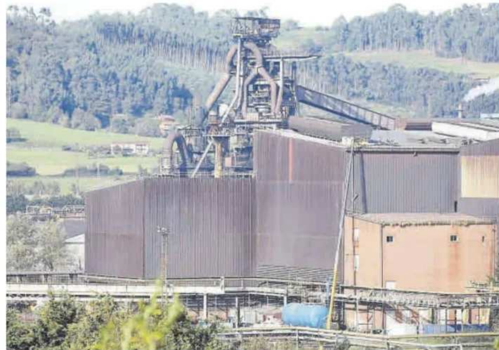
Obras, ayer, en el exterior de la acería de Gijón para la instalación del horno de arco eléctrico. | Ángel González
