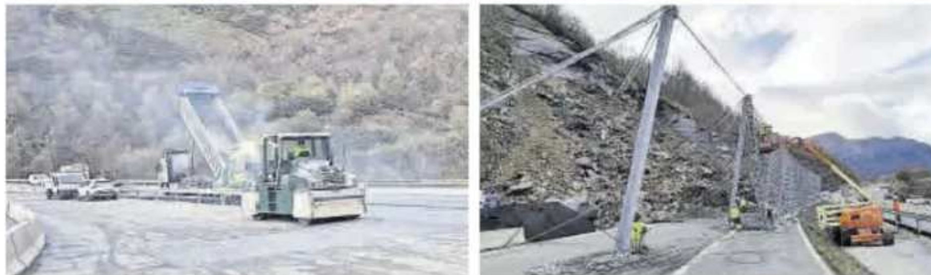
Arriba, el asfaltado del desvío que permitirá reabrir la autopista del Huerna. Debajo, por la izquierda, otro momento de los trabajos y la colocación de una gran malla. | Ministerio de Transportes
