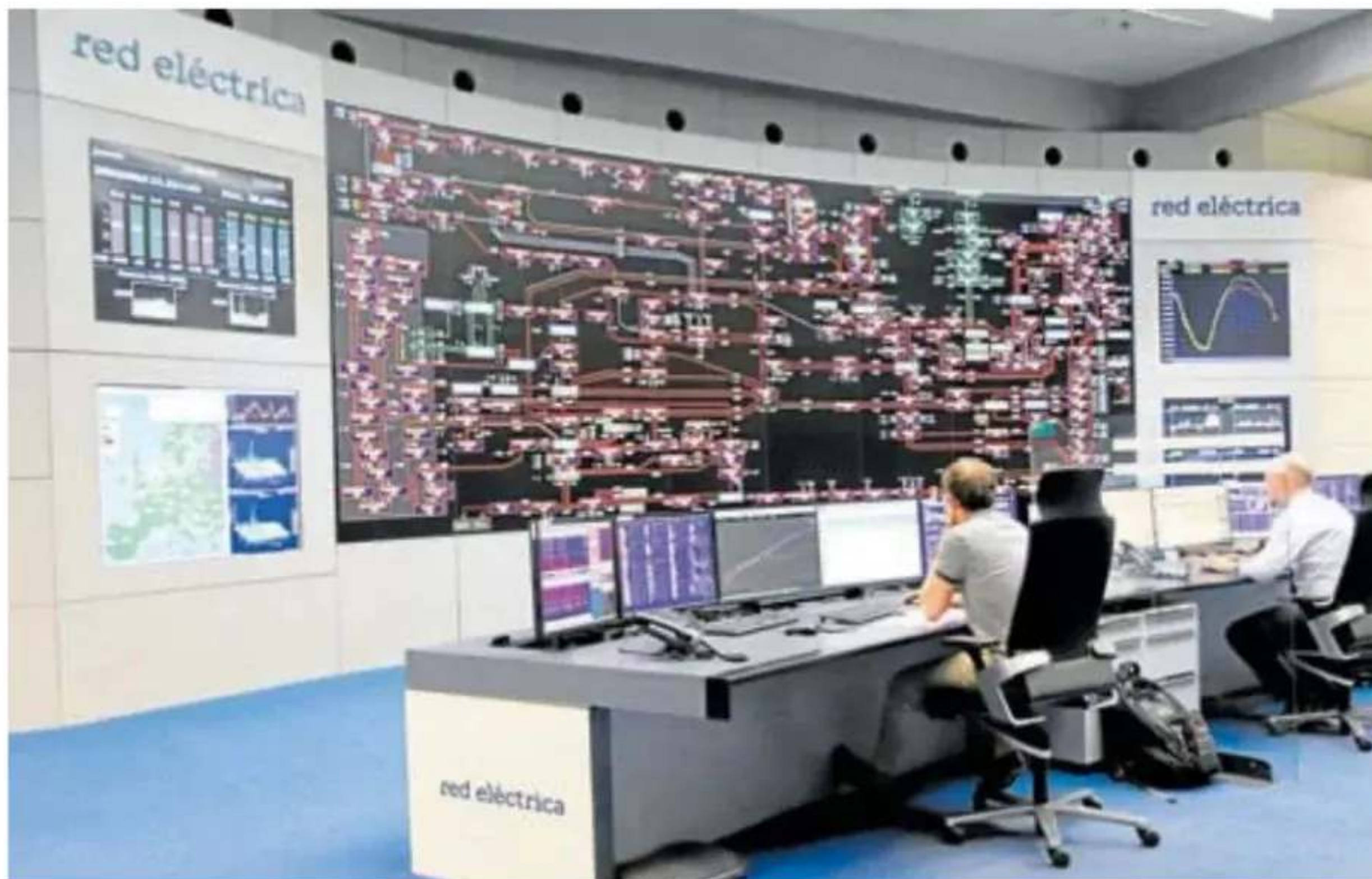
Centro de control de Red Eléctrica. ABC
