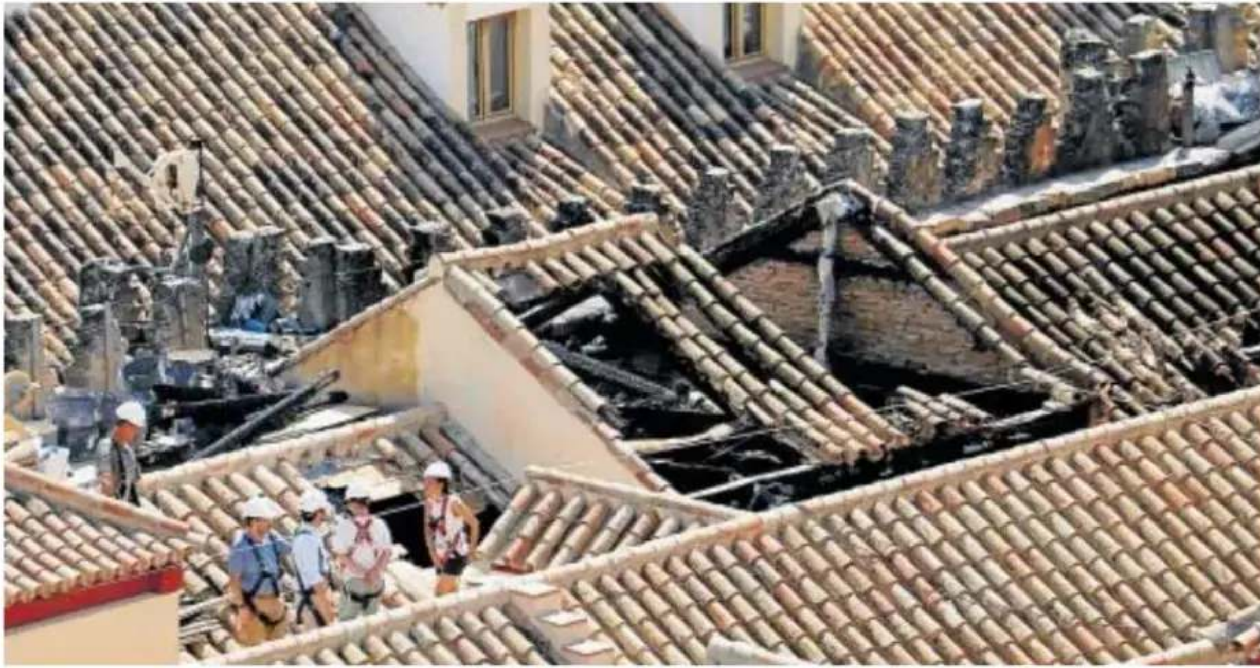
Los técnicos evalúan los daños en el tejado del edificio después de que colapsara el techo de una de las capillas // EFE
