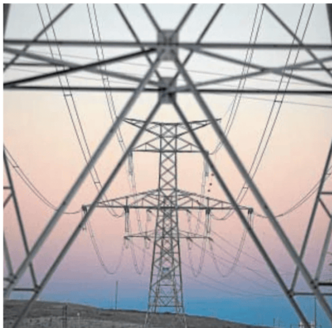
Torres de alta tensión eléctrica // JAIME GARCÍA
