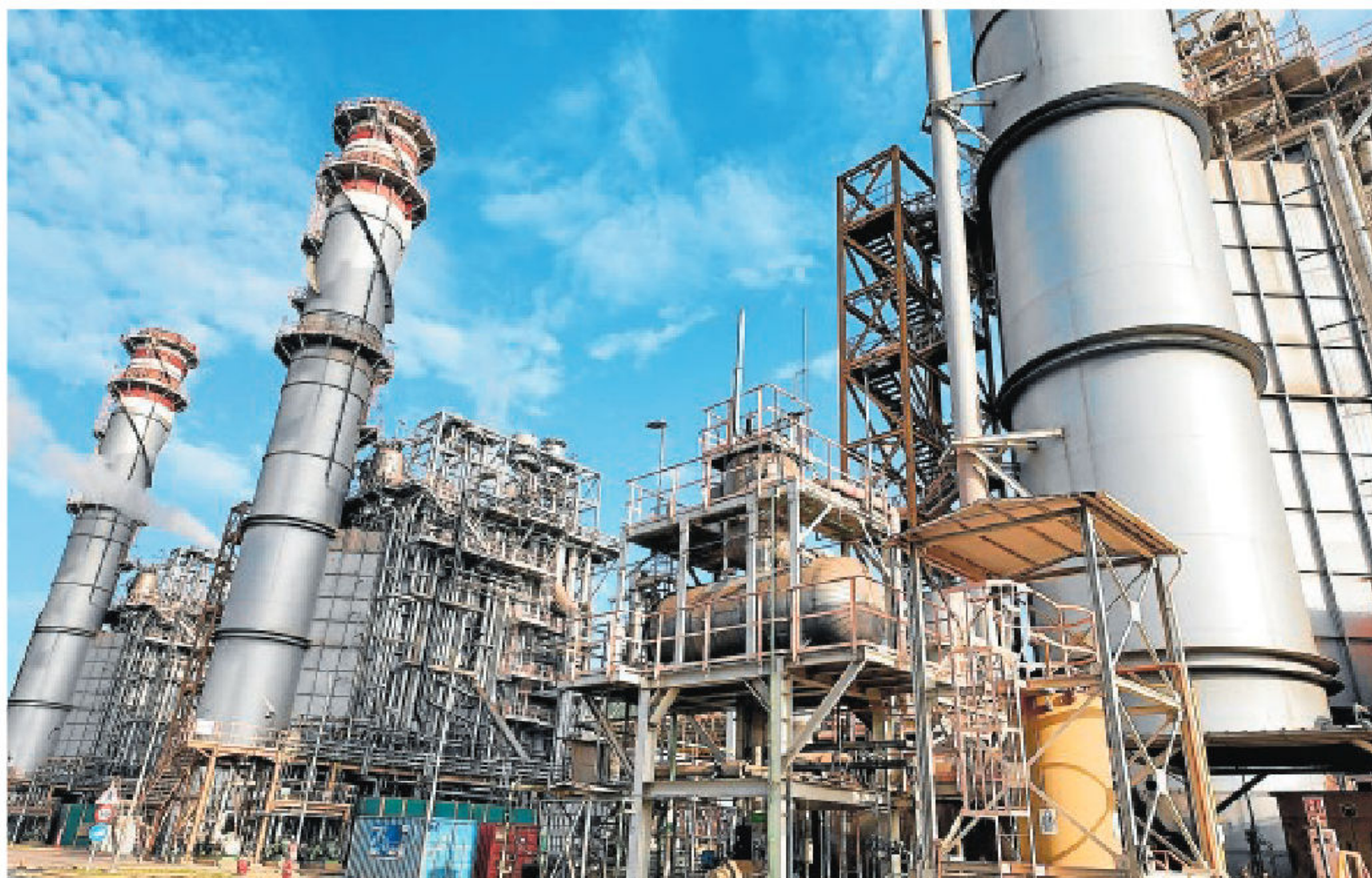
Central de ciclo combinado de Palos de la Frontera (Huelva) // ABC
