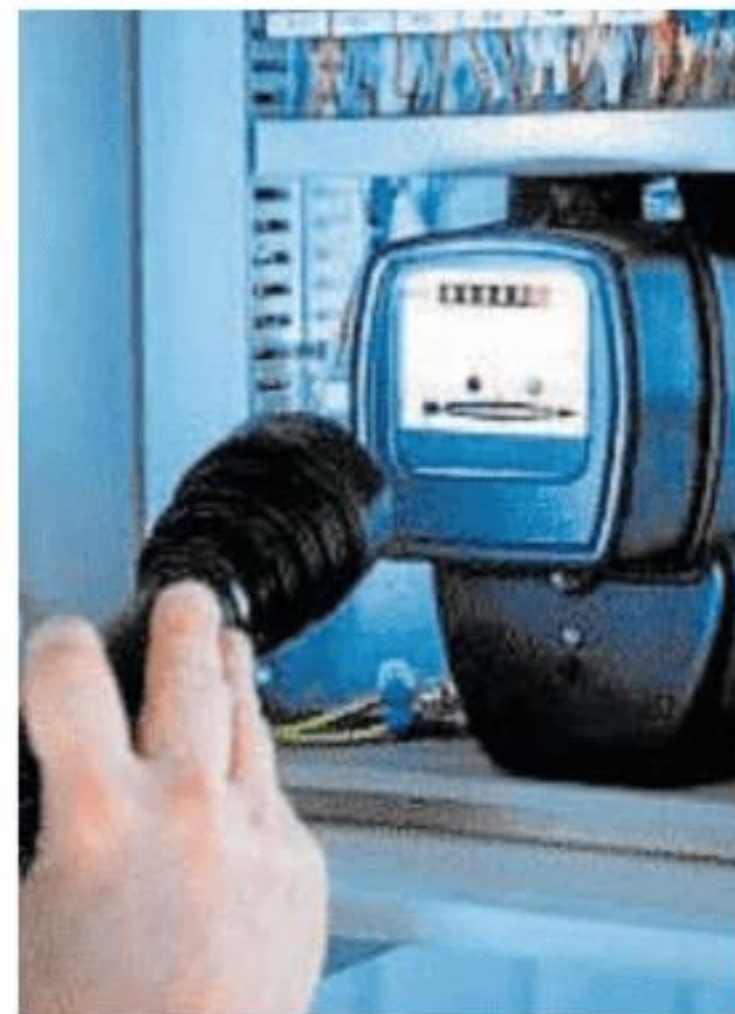
Contador de electricidad // ABC
