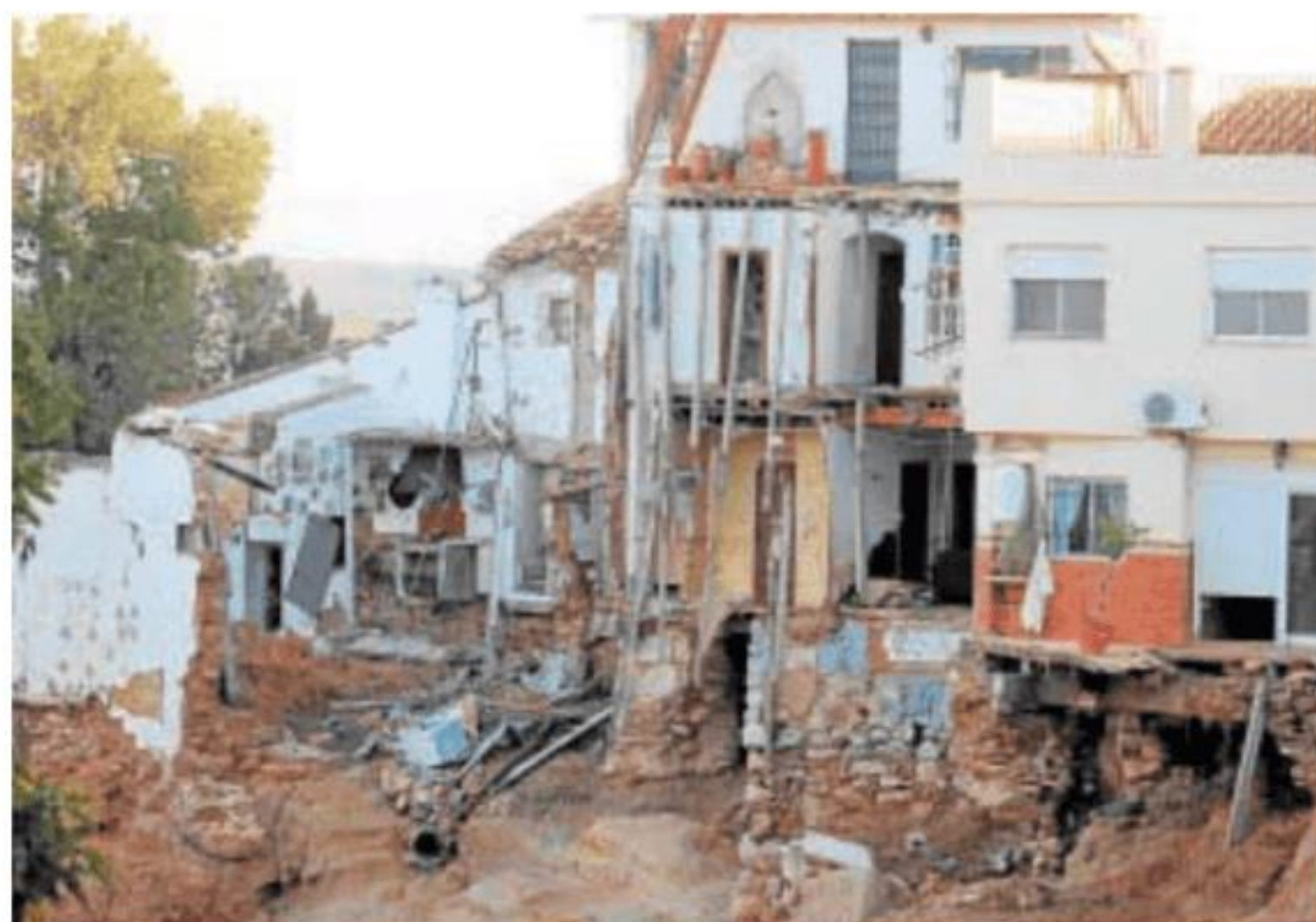
Una vivienda destrozada por el paso de la dana // JAIME GARCÍA
