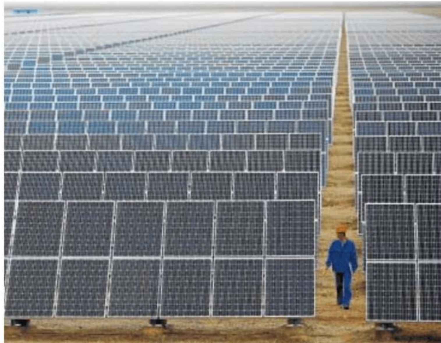
Un operario inspecciona un huerto solar en Dunhuang (China) // REUTERS
