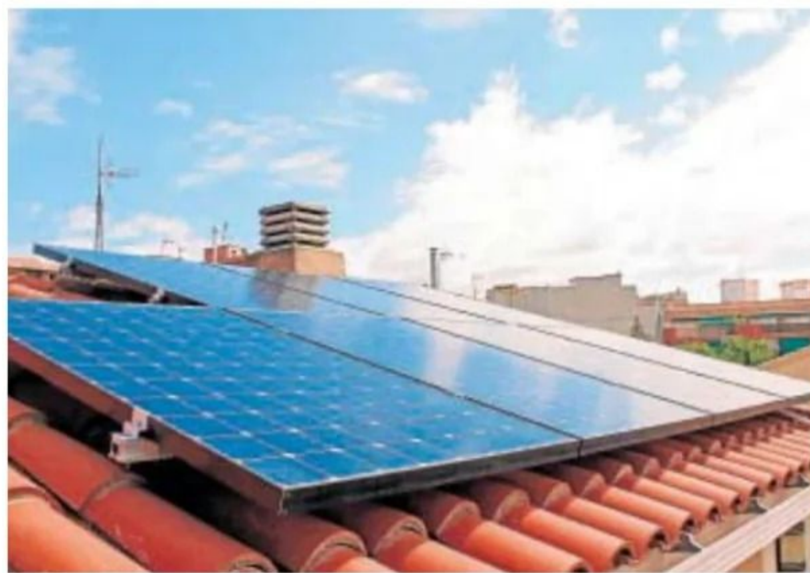
Una instalación de energía fotovoltaica en un edificio // ABC
