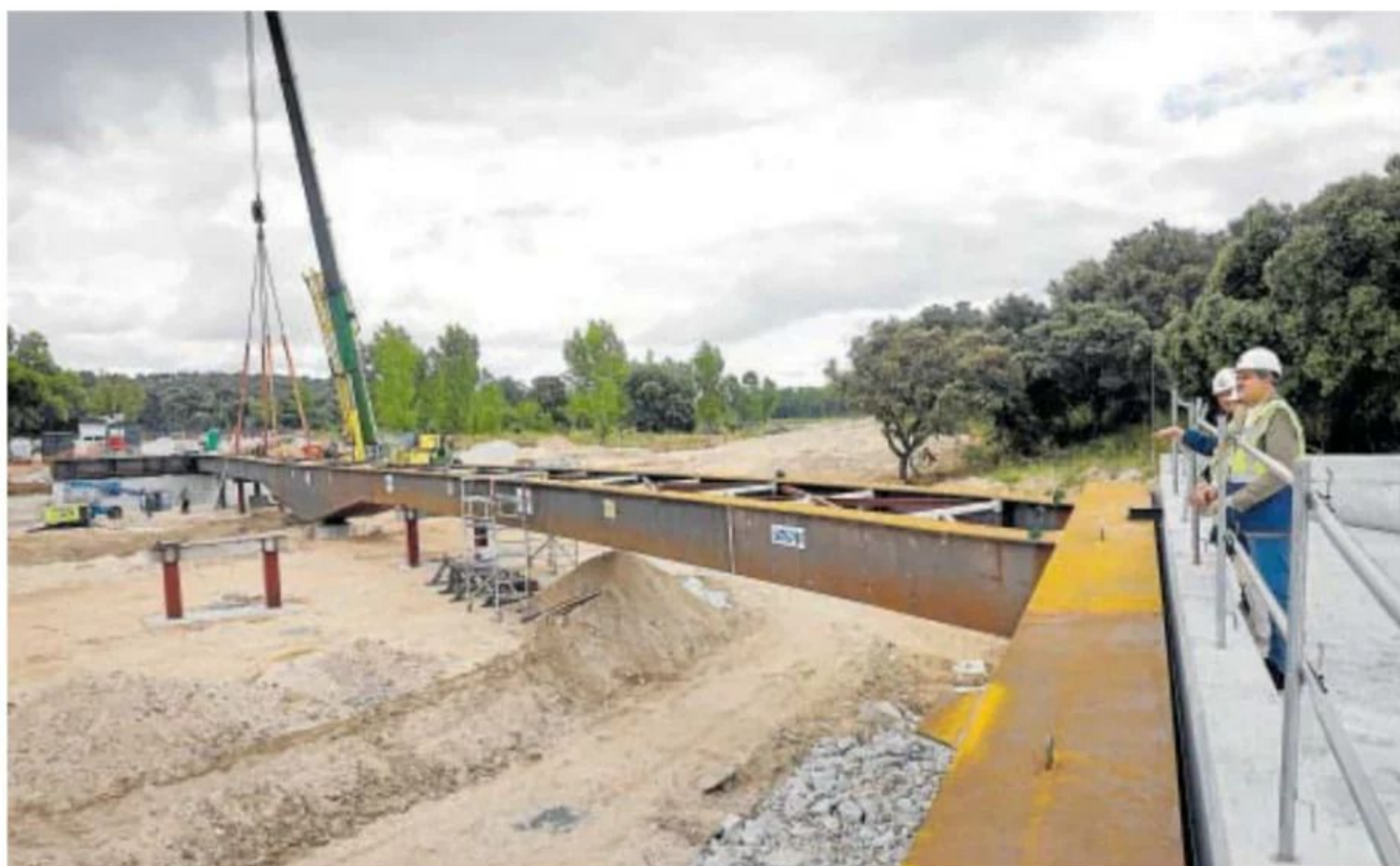
El consejero Rodrigo, junto a uno de los puentes que se están construyendo en Aldea del Fresno // COMUNIDAD
