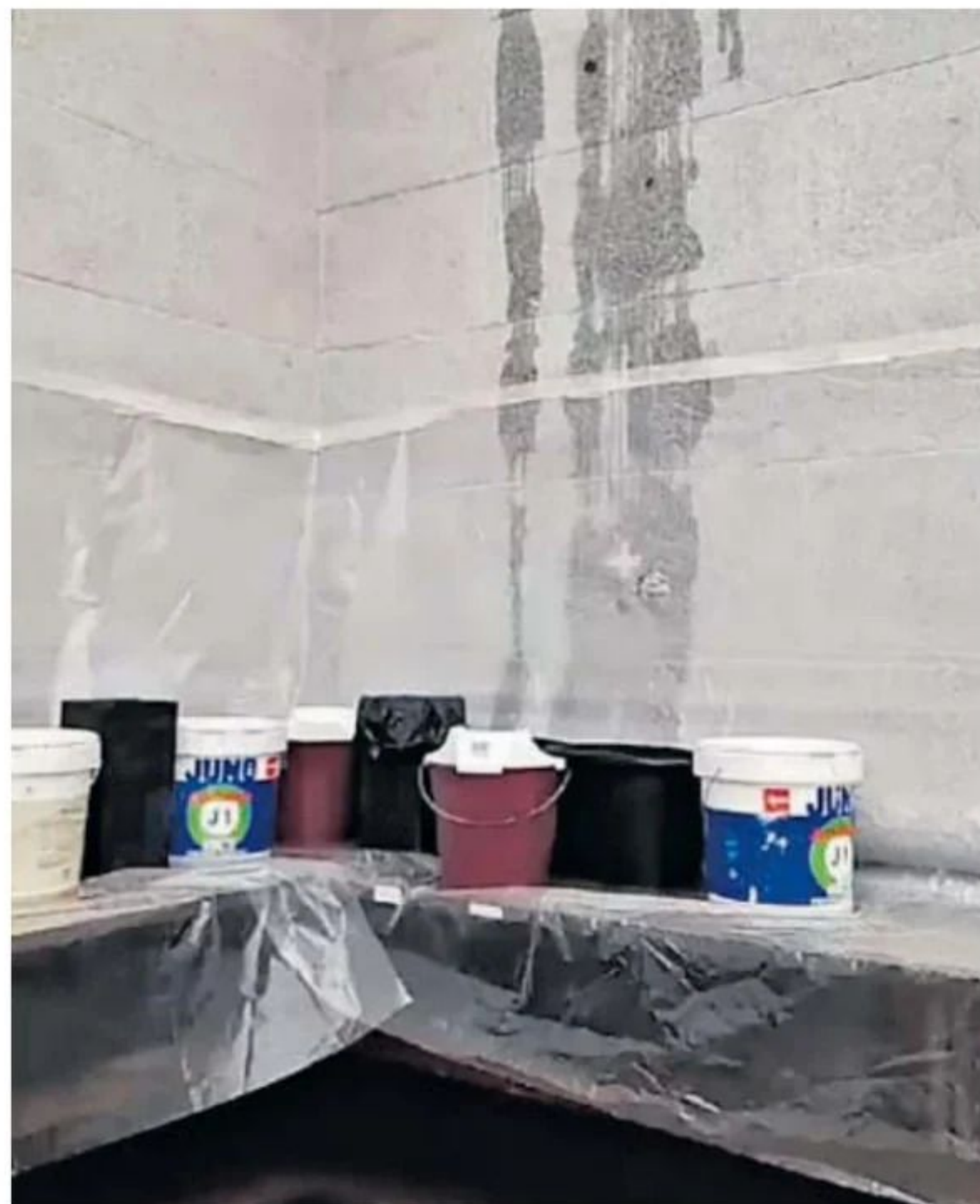
Goteras en la sala de catalogación de la BNE durante la DANA // ABC
