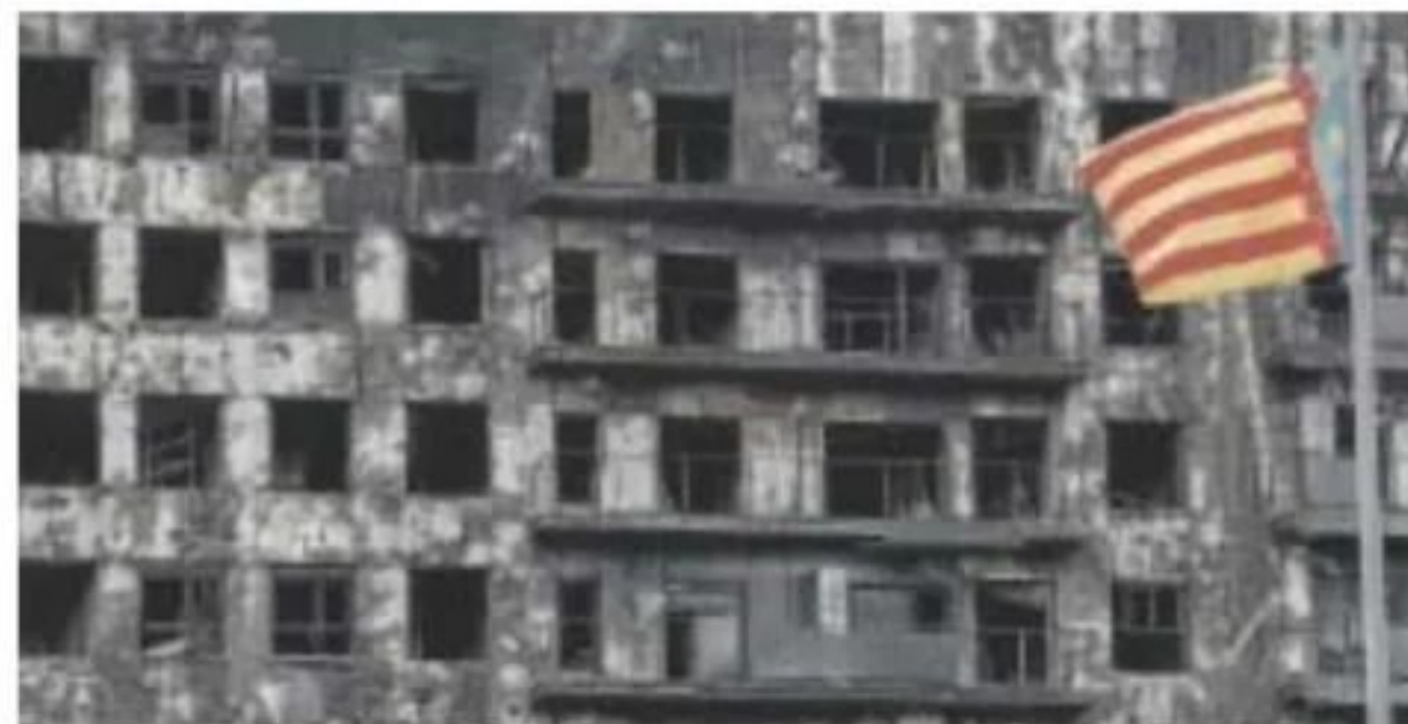
Restos del edificio incendiado en Valencia // EFE
