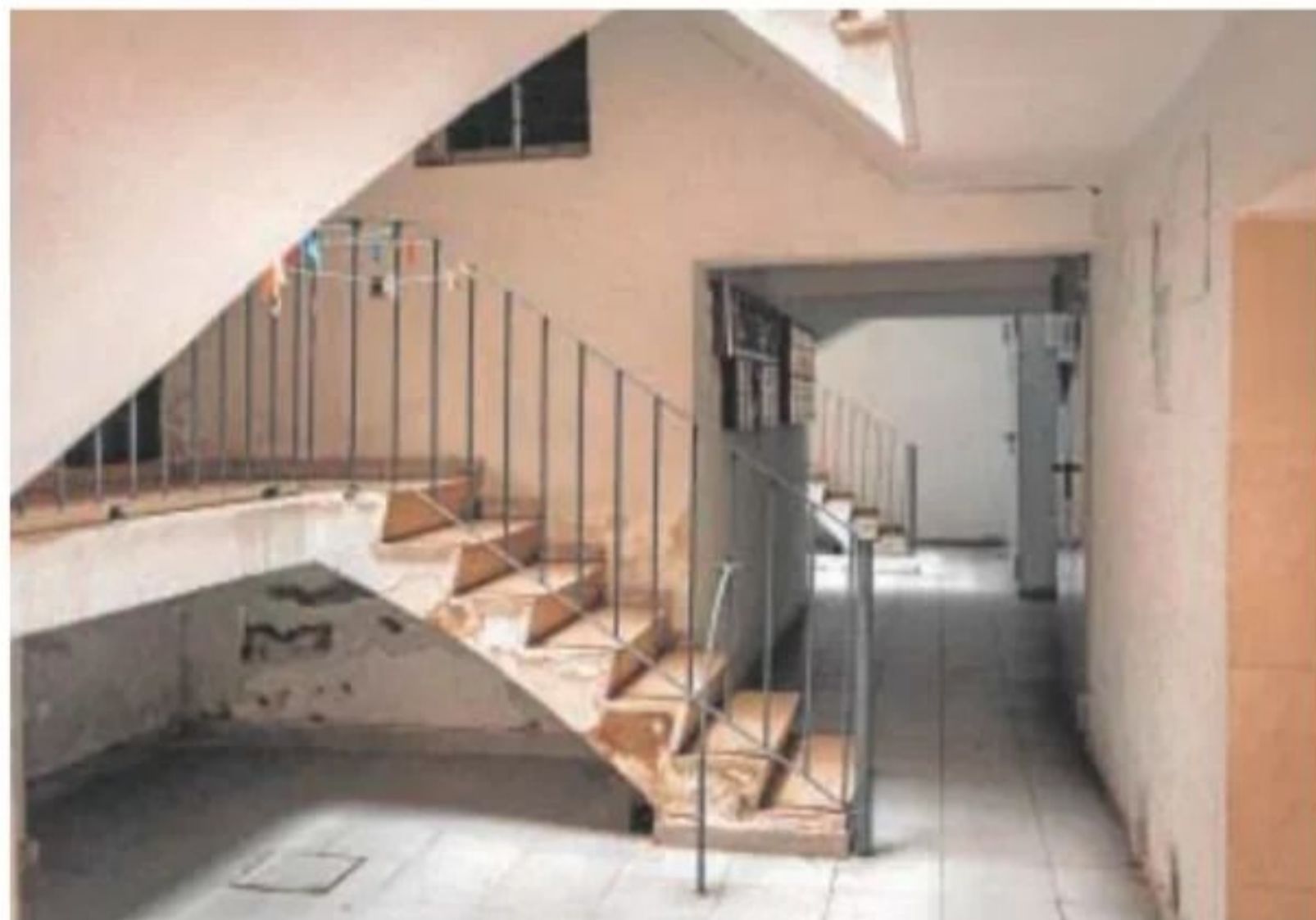
Las humedades en uno de los patios interiores
