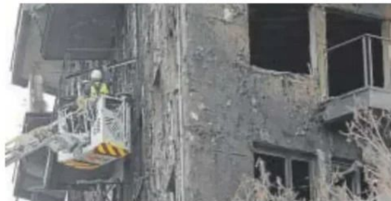
Saneamiento del edificio incendiado en Valencia //EFE
