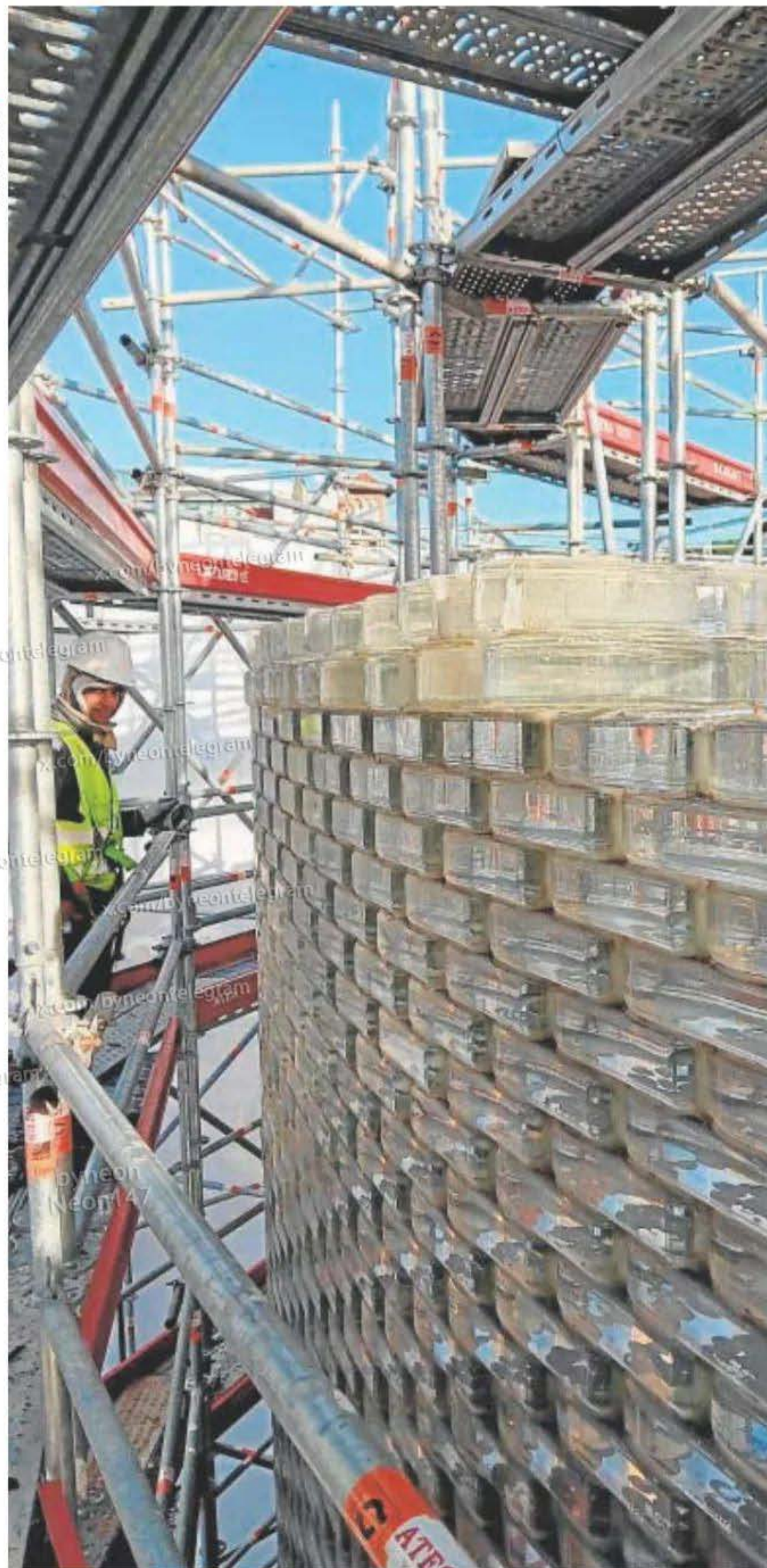
Un momento del desmontaje de la parte exterior del monumento, pieza a pieza // COMUNIDAD
