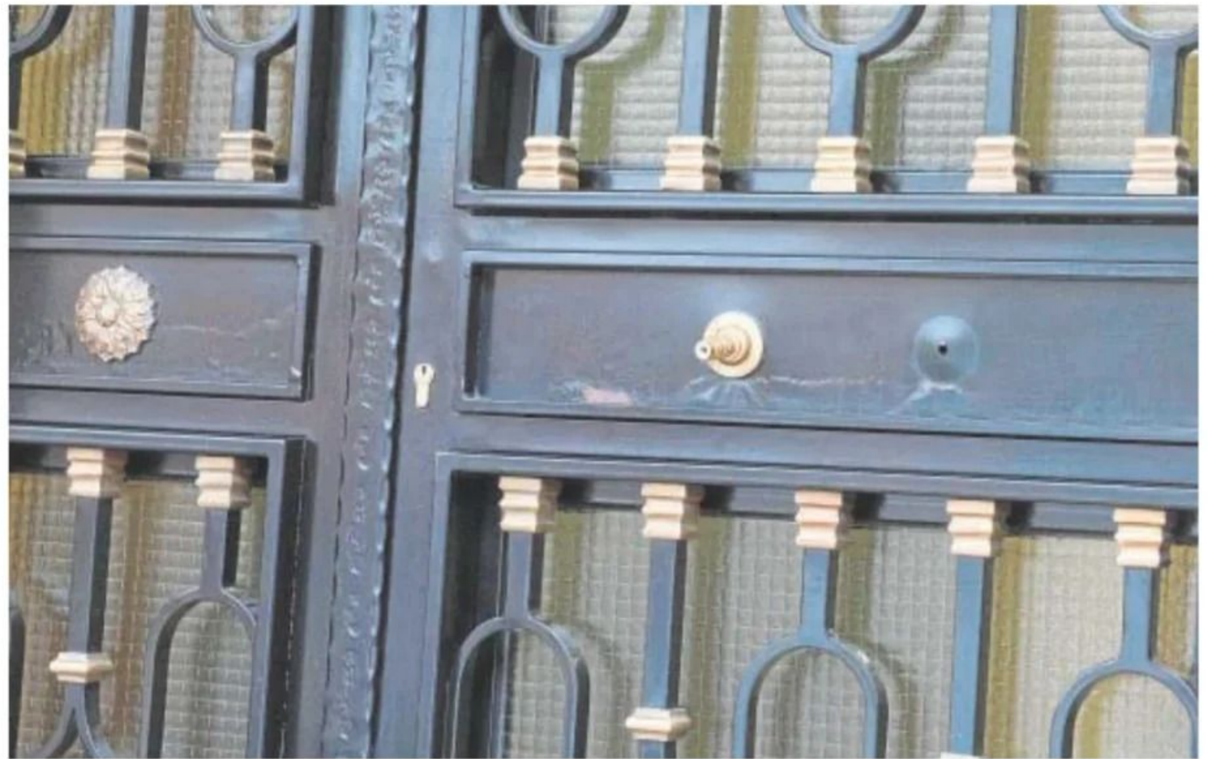
Un portal al que los ladrones le han sustraído el tirador // DE SAN BERNARDO
