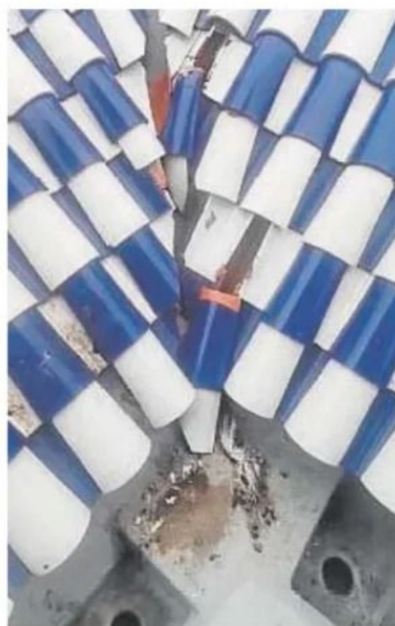
Tejas azules y blancas dañadas // ABC
