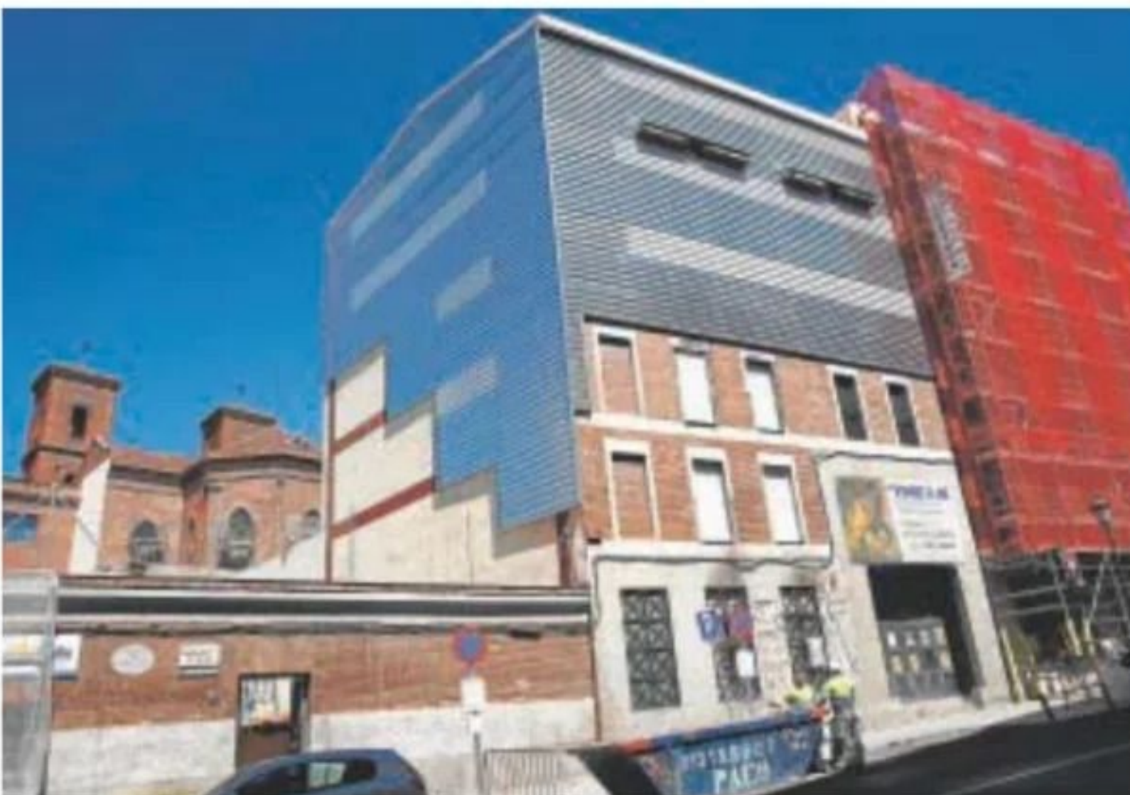
El estado actual del inmueble siniestrado, en la calle de Toledo, 98 // JAIME GARCÍA
